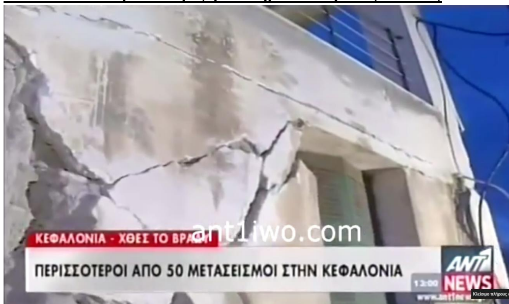
Εικόνα 30: Υλική καταστροφή σε κτήριο του νησιού (27/01/14)
