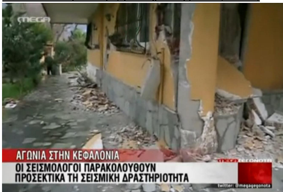
Εικόνα 29: Υλική καταστροφή σε κτήριο – Αργοστόλι (27/01/14)
