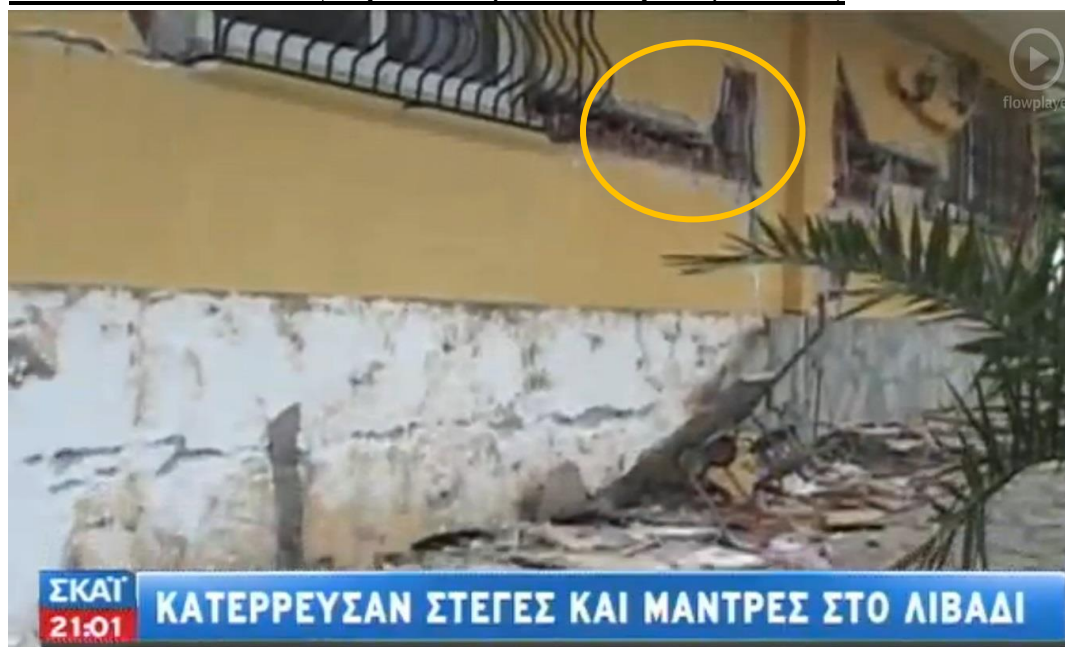
Εικόνα 43: Επιπτώσεις κύριου σεισμού στο Λιβάδι (27/01/14)
